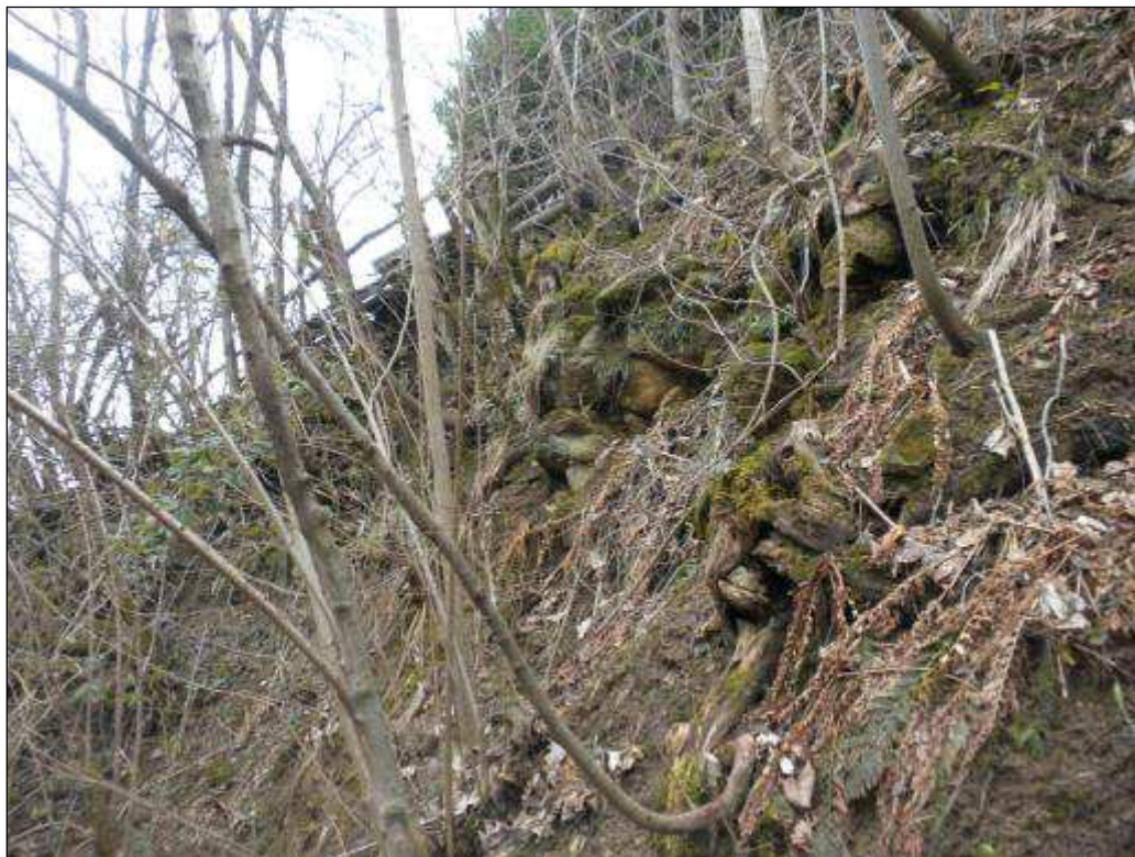
Fig. 3: – La scarpata subverticale del coronamento del dissesto
