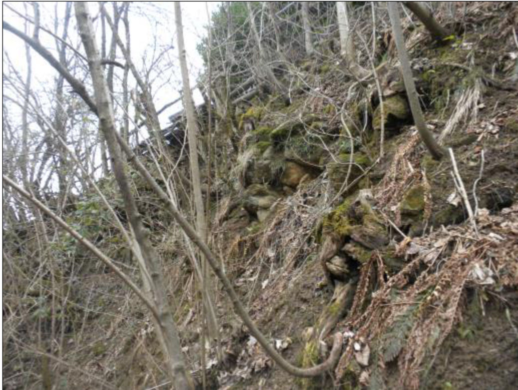
Fig. 3: – La scarpata subverticale del coronamento del dissesto
