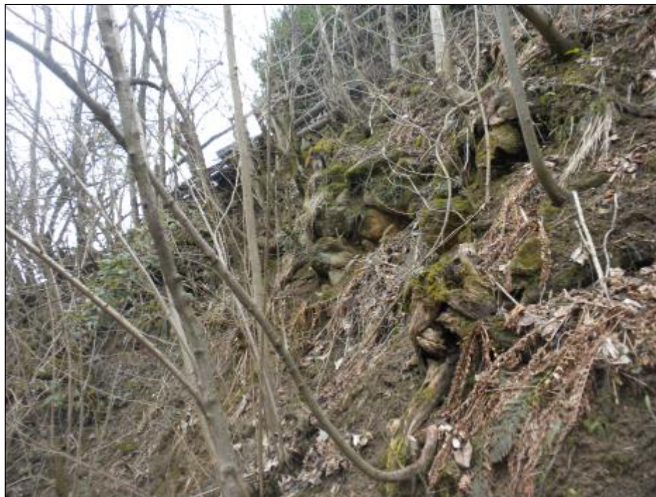
Fig. 7: – La scarpata subverticale del coronamento del dissesto
